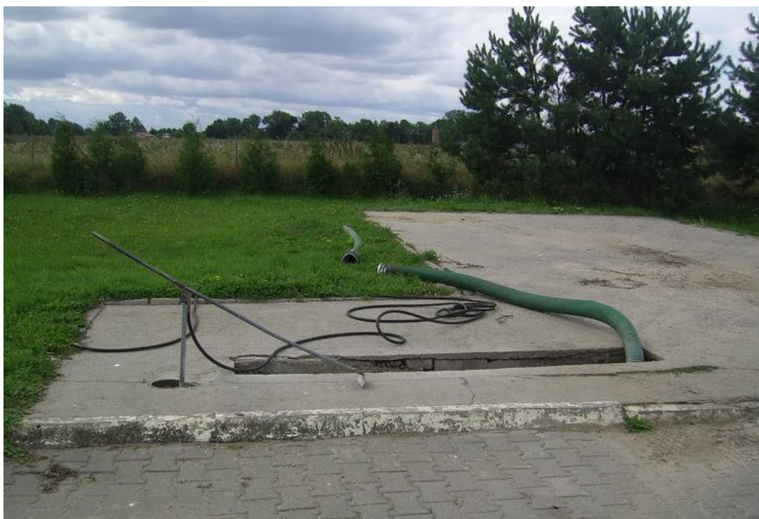
Zdjęcie nr 7. Stacja zlewna.
