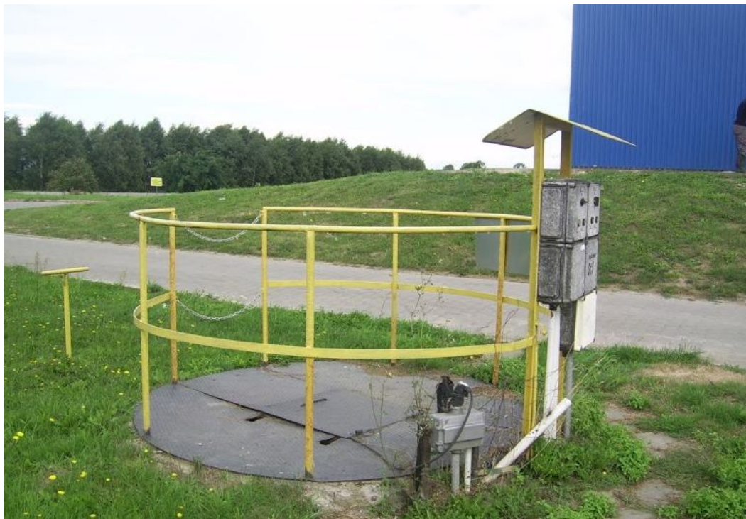
Zdjęcie nr 11. Przepompownia ścieków własnych.
