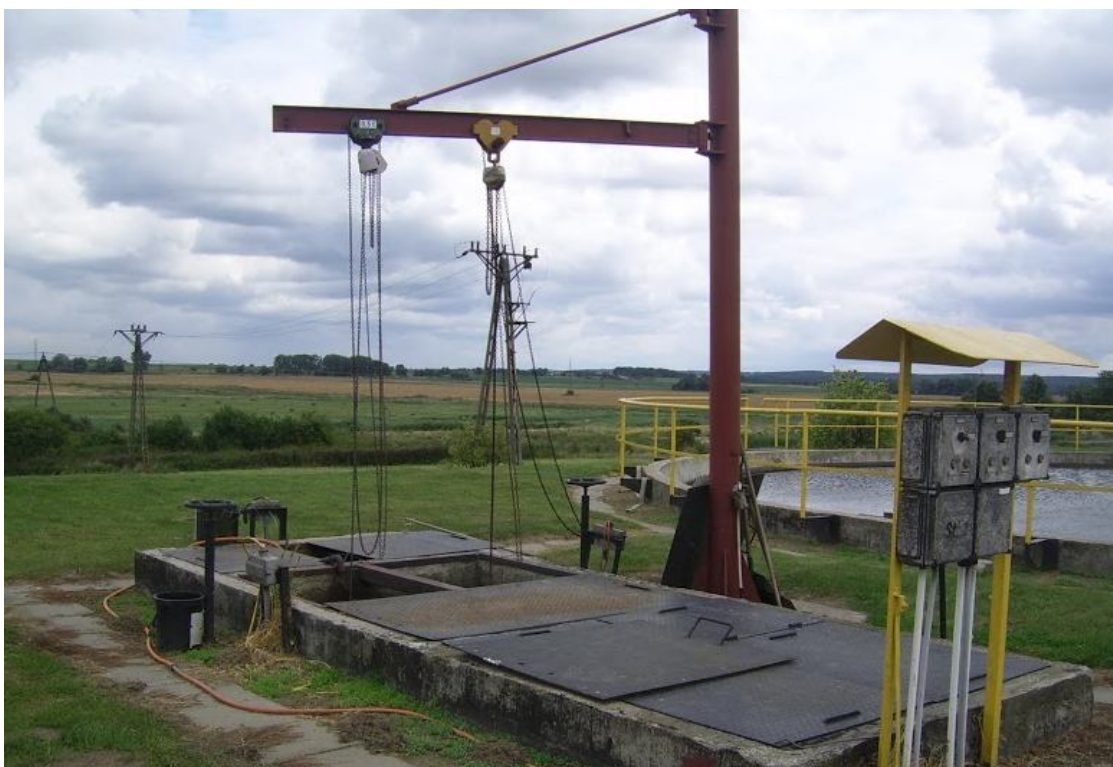
Zdjęcie nr 20. Przepompownia osadu i PT.
