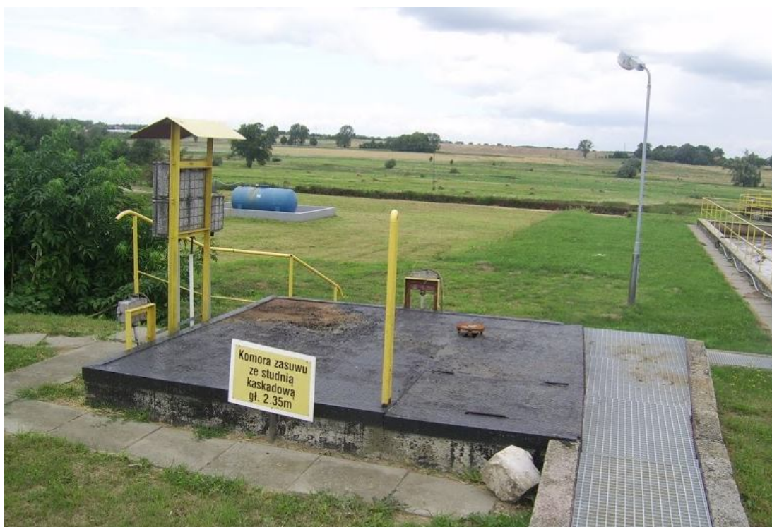
Zdjęcie nr 5. Komora zasuw.
