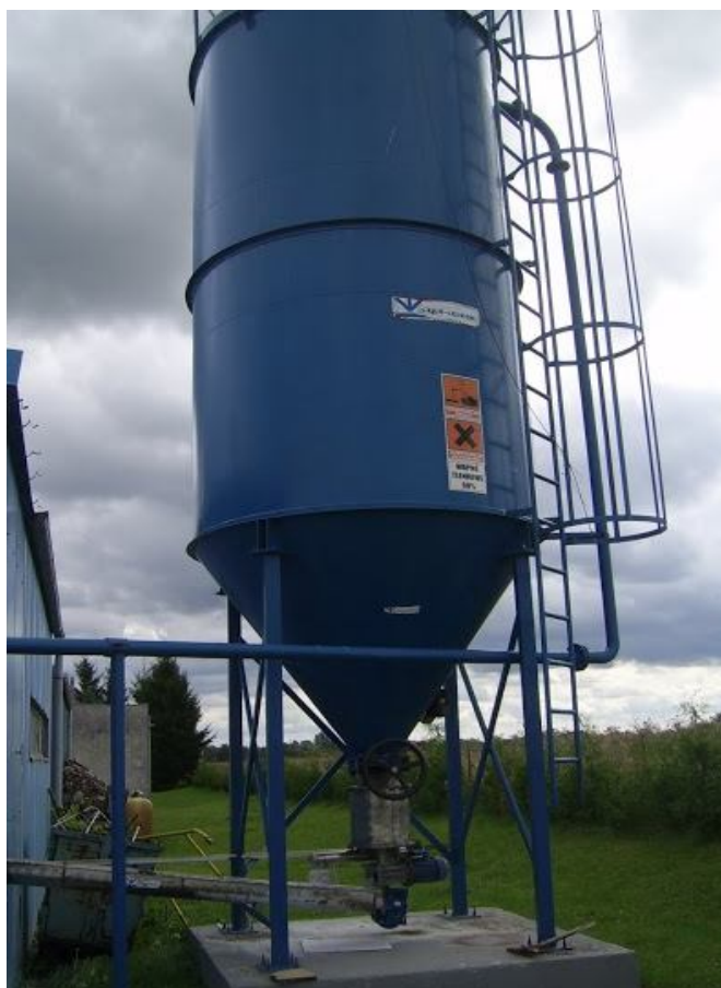
Zdjęcie nr 8. Zbiornik wapna.
